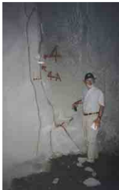
Figuur 3. scheuren in het beton bij overgang van stalen bogen (rechts) naar alleen shotcrete (links)
