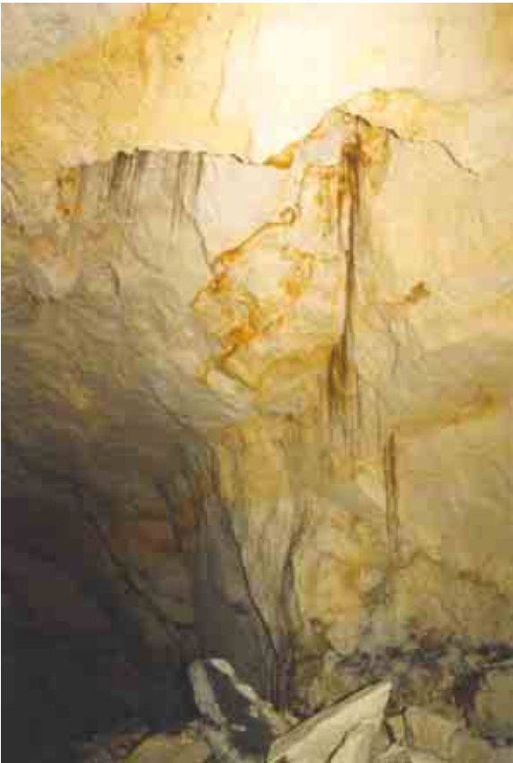
Fig. 8. Plantenwortels die door storingen in het mergeldak tot in de ondergrondse groeve zijn gegroeid.
