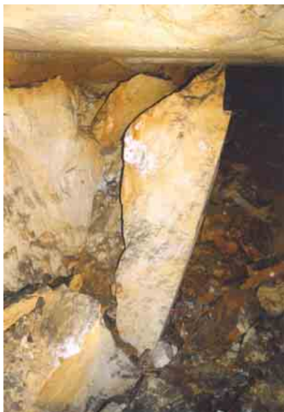
Fig. 4. Tijdens een grootschalige instortingen afgesholde pilaarwand, die, voordat deze door rotatie naar rechts op de vloer terecht kon komen, door het plotseling neerdalende groevedak is vastgeklemd.
